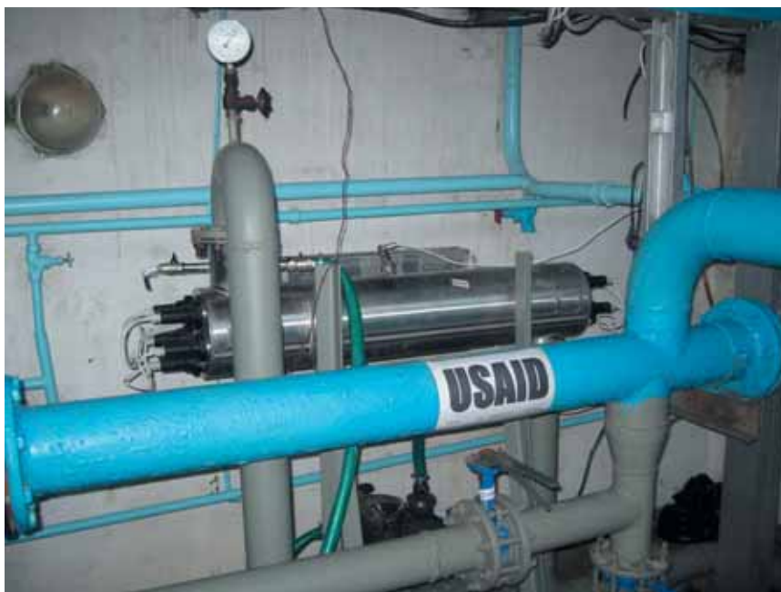
Установка по УФ обеззараживанию воды на водозаборе поселка Осиновая Речка
